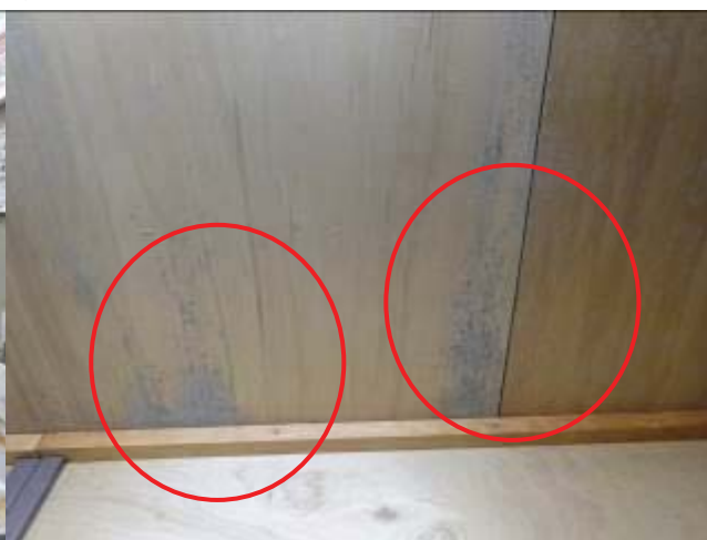
写真2 天井にはカビ
