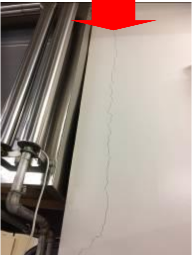
写真6 9月の震災で壁に縦の亀裂発生
