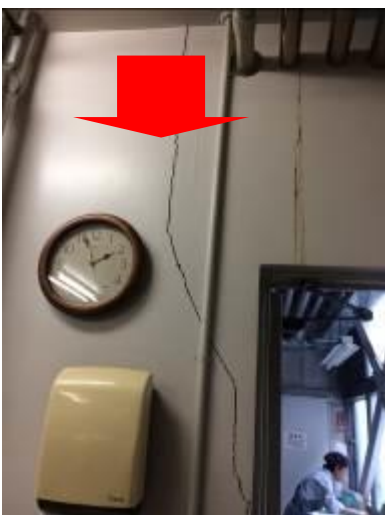
写真7 9月の震災で壁に縦の亀裂発生
