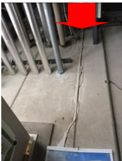
写真8 9月の震災で壁に縦の亀裂発生
