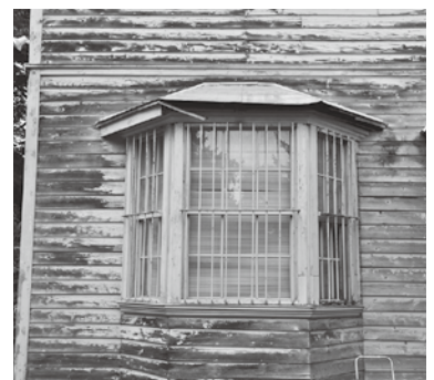
写真4 劣化が進む窓周辺の様子
